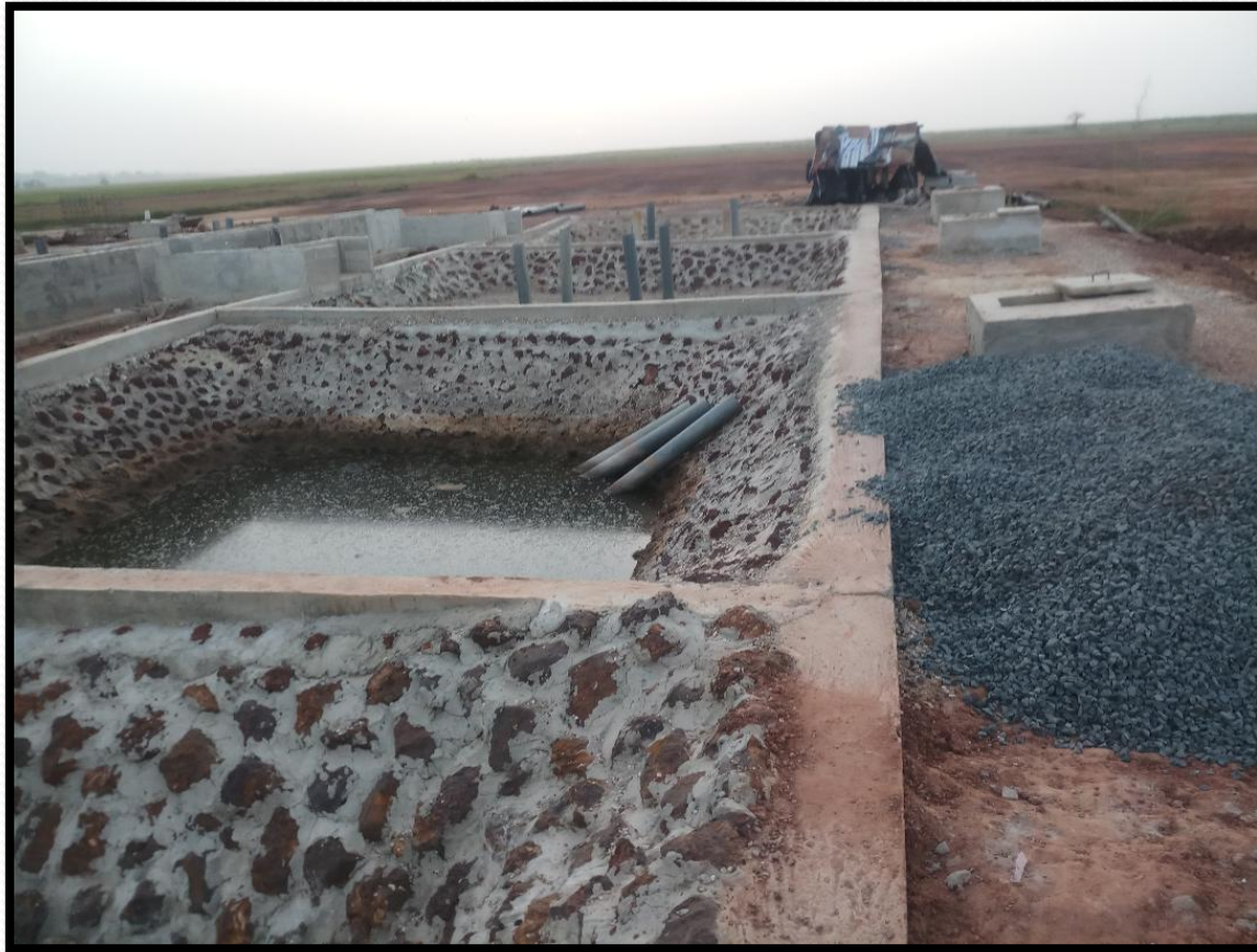
Station de traitement et de valorisation de boues de vidanges
